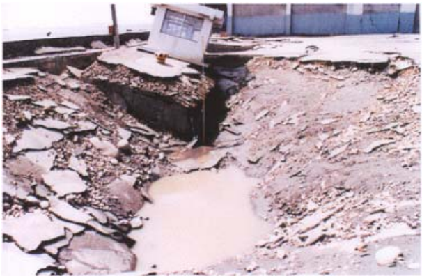
照片八 台中港碼頭護岸嚴重地盤沈陷之近照
