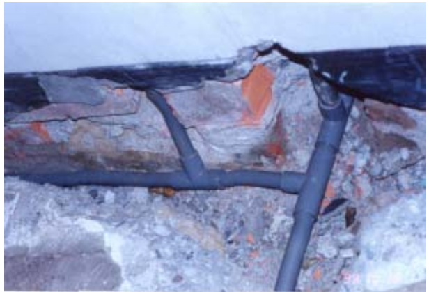
照片九 南投市新興路因液化房屋下陷導致水管外露
