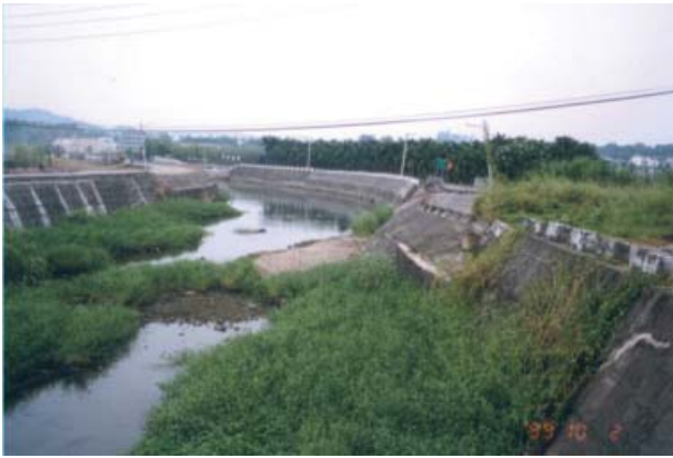
照片六 南投縣草屯鎮隘寮溪河堤護岸設施破壞
