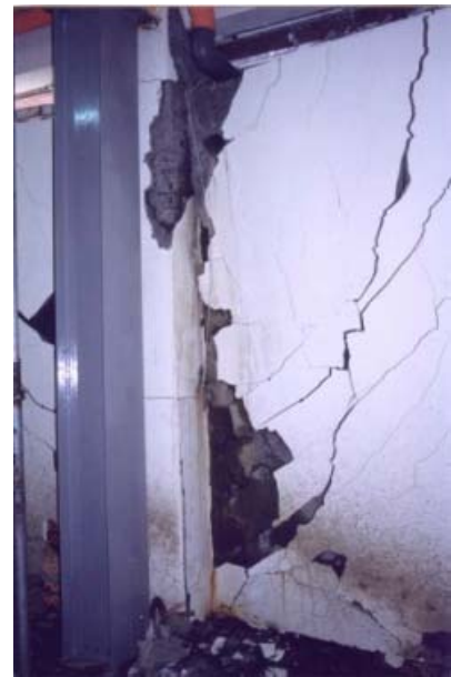
照片五 霧峰鄉大安醫院地下室外牆受地盤流動壓力作用之損害情形
